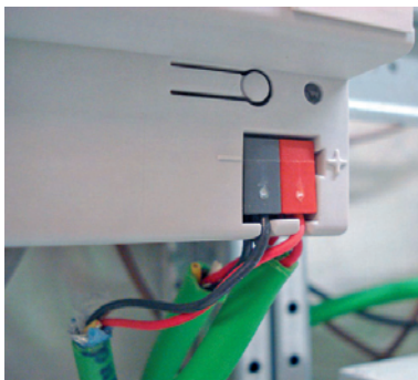
Abb. 5.7: Mit grünem EIB-Buskabel sind alle Aktoren im Schaltschrank miteinander verbunden.
