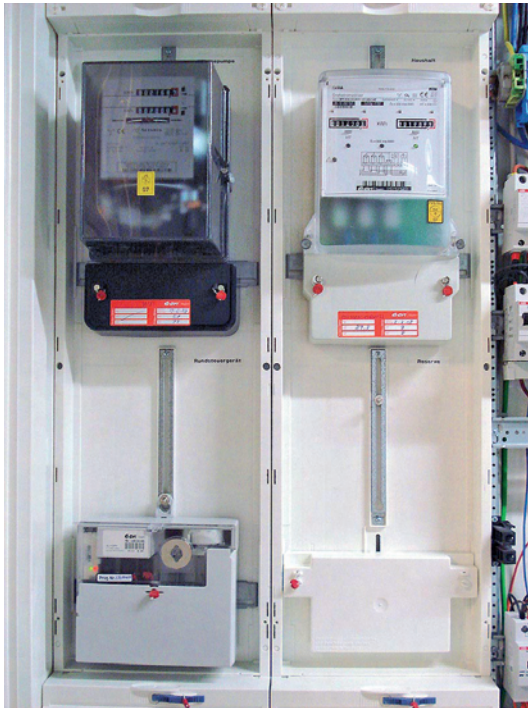
Abb. 5.2: Hier gibt es vier Plätze für Stromzähler. Neben dem Zähler für die Wärmepumpe ist ein weiterer für den Haupt- und Nebentarif installiert. Das Rundsteuergerät hat einen eigenen Platz, daneben die Reserve für Photovoltaik.
