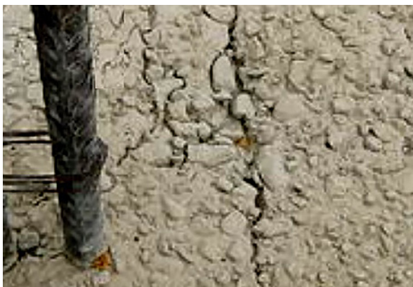
Bild 2.3: Setzungsrisse über der horizontalen Bewehrung
